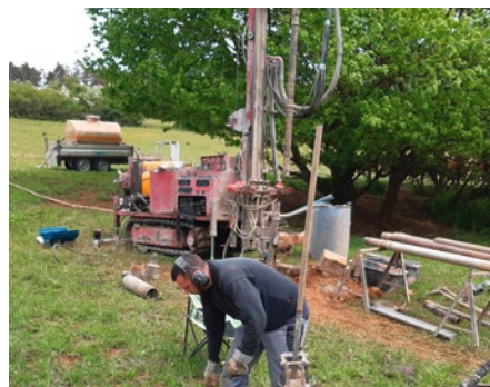
Erkundung mit Kleinbohr- und Großbohrtechnik beim oberen Damm-Standort für das geplante Hochwasserrückhaltebecken (HWR)
