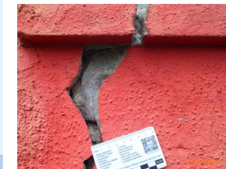
Massiver Setzriss an Gebäudeecke. Nahe eines Bohrpfahlschachtes kam es zu einer deutlichen Vergrößerung eines Altschadens.
